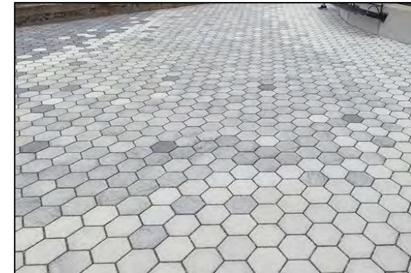
Pervious gradient pavers
